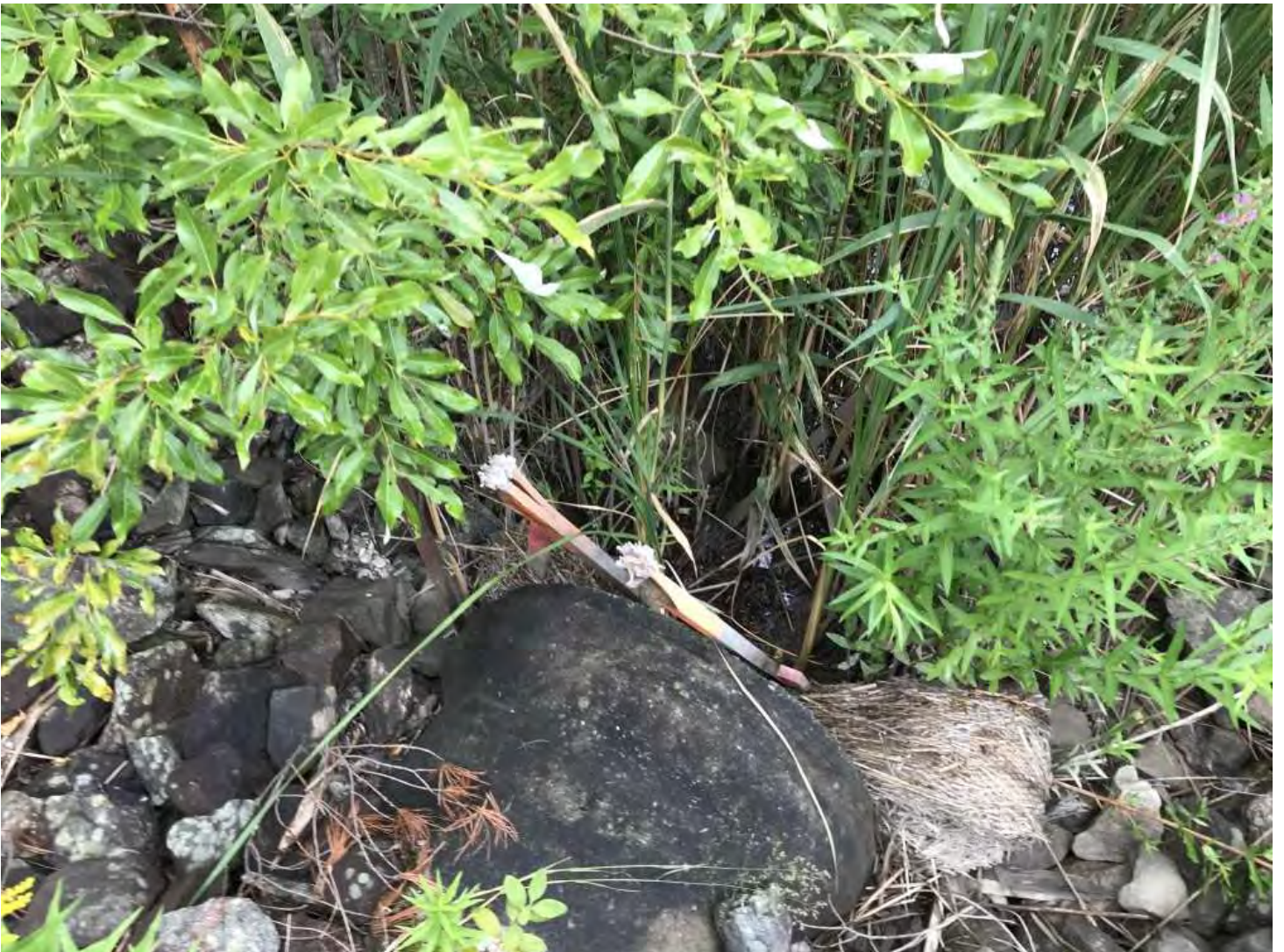
IMG_0785.JPG Image 12: Exutoire du fossé est et de l'eau de fonte du LEN. Présence de bermes filtrantes directement avant d'entrer dans le ponceau de sortie.
