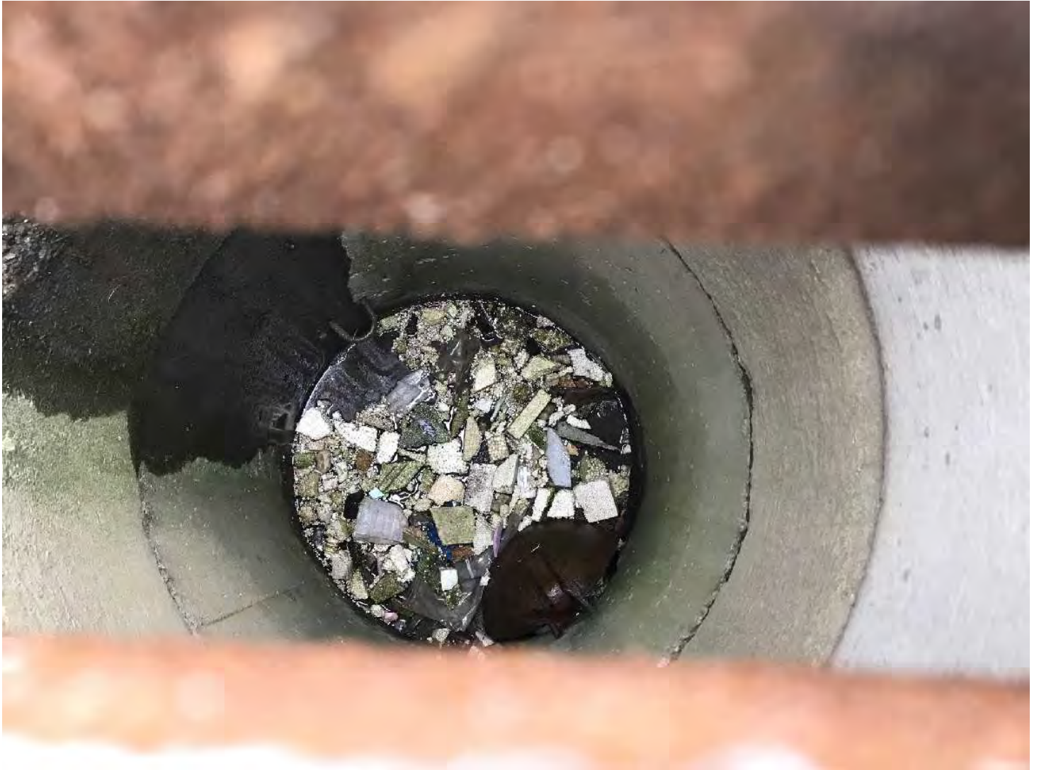
IMG_0751.JPG Image 15: Vue de l'intérieur du trou d'homme du point GPS 0052. Présence de styromousse
