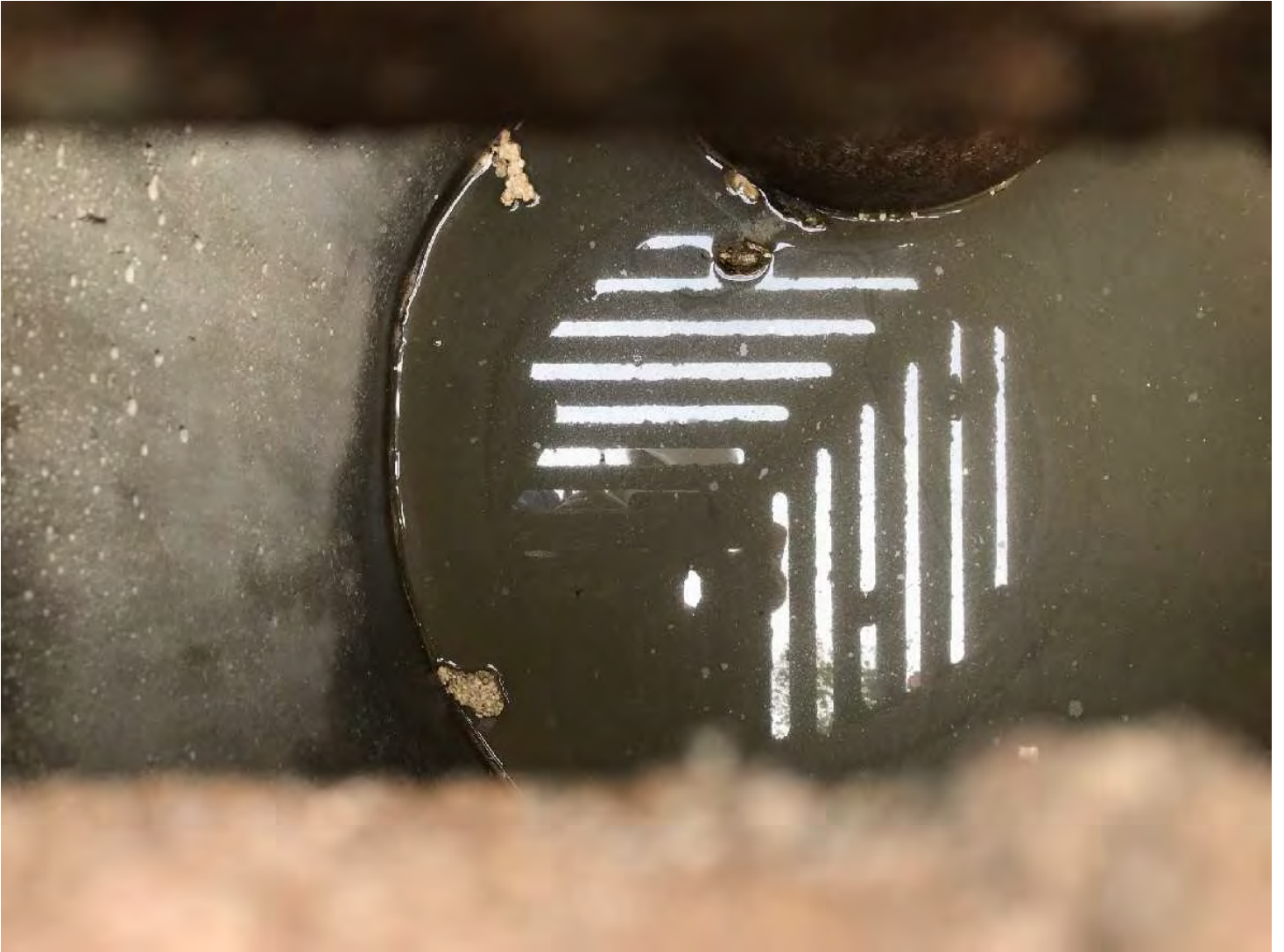
IMG_0771.JPG Image 31: Vue de l'intérieur du trou d'homme localisé au point GPS 0058
