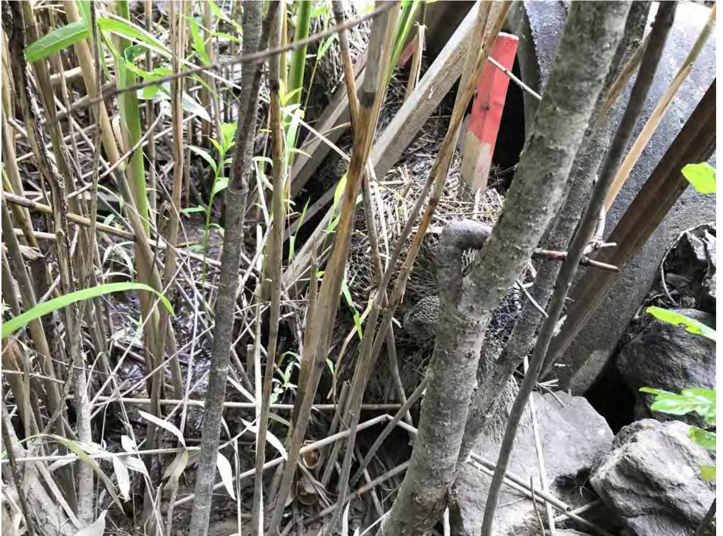
IMG_0786.JPG Image 13: Vue alternative du ponceau de sortie. Eau et 2 morceaux de styromousse
