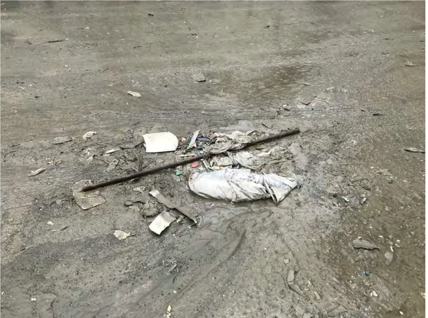
IMG_0844.JPG Image 25: 10h30 - Regard pluvial de la plateforme E. Le regard est colmater par une toile de plastique
