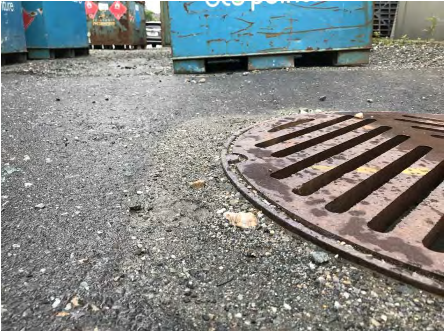
IMG_0752.JPG Image 16: Contour du regard du trou d'homme du point GPS 0052. Présence d'écaillés de peinture jaune (similaire à la peinture de signalisation)
